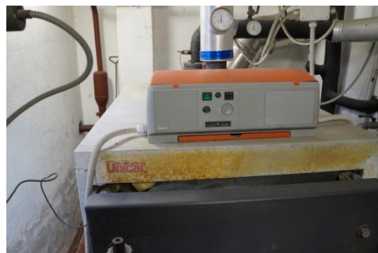
Figura 8.3 – Particolare generatore di calore esistente
