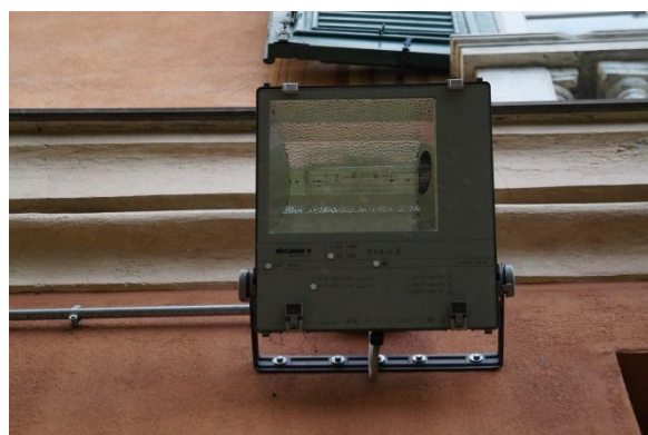
Figura 4.17 - Particolare di un proiettore alogeno installato all'esterno
