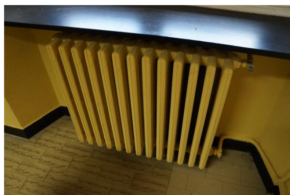
Figura 4.6 - Particolare dei radiatori installati
