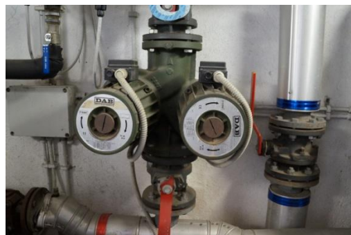
Figura 8.7 – Particolare pompe di circolazione
