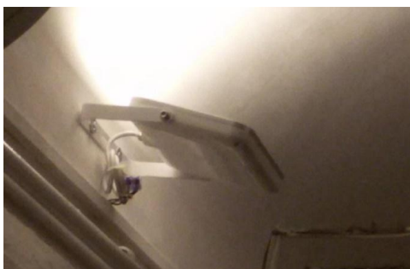
Figura 4.16 - Particolare di un proiettore LED installato all'interno
