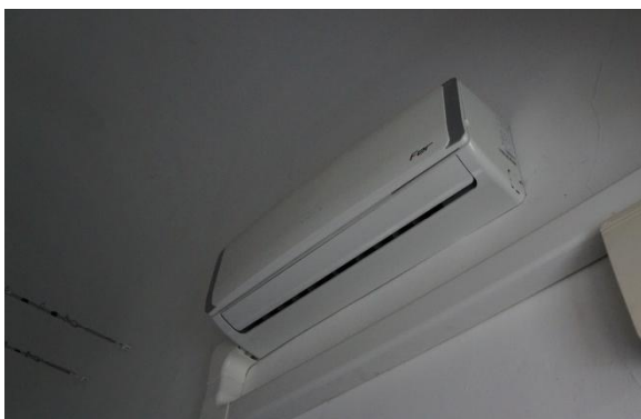
Figura 4.13 - Particolare di unità interna del sistema di climatizzazione estiva
